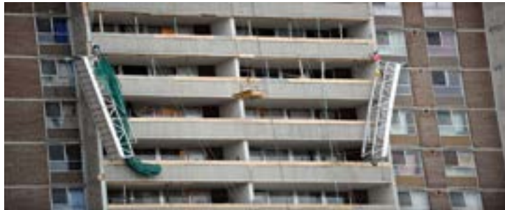
En décembre 2009, cinq ouvriers kazakhs étaient tombés du 13 e étage d'un édifice quand l'échafaudage sur lequel ils travaillaient a cédé sous leur poids. Photo: CBC
